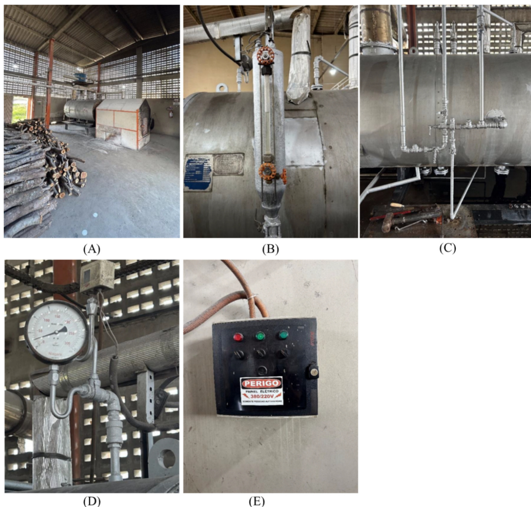
Figura 2: a) Casa da Caldeira, b) Visor de nível, c) Sistema de injeção de água, d) Manômetro e Pressostato, e) Quadro elétrico de acionamento. Fonte: Autoria Própria.
